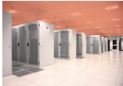
Protezione del soffitto presso data center
